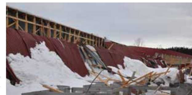
Svinstall som dimensionerats i en för låg snözon. Utknäckning av ostagade tryckta strävor orsakade kollapsen. Tillverkaren av takstolarna var ej certifierad.
