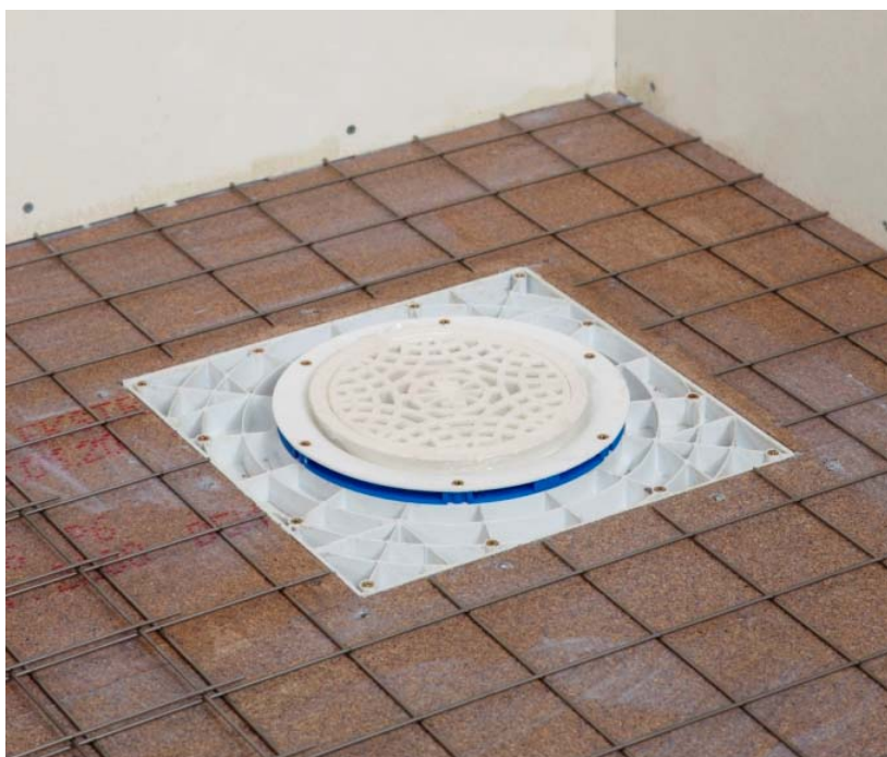
Foto 18. Underkantsarmering och monteringsplatta.
