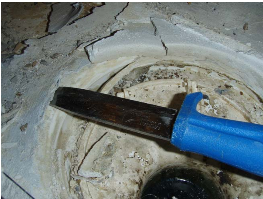
Foto 3. Ingen klämring monterad och brunnsmanschetten sitter inte fast mot golvbrunnen.
