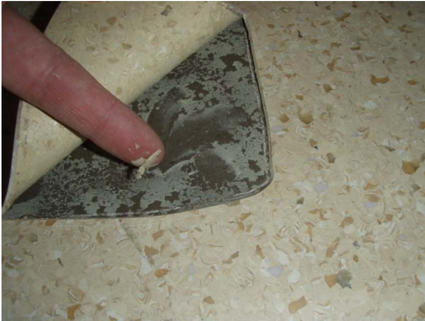
Foto 9. Nedbrytning av plastmatta och mattlim vid en skadeutredning på grund av fuktigt underlag.
