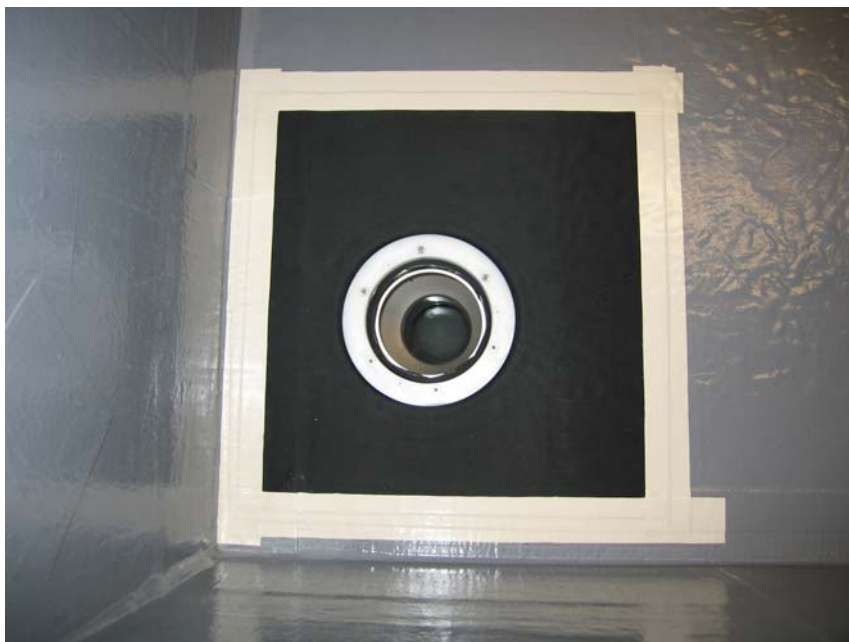
Foto 6. Extra tätning (ej med i monteringsanvisningen) vid brunnsmanschetter efter läckage.
