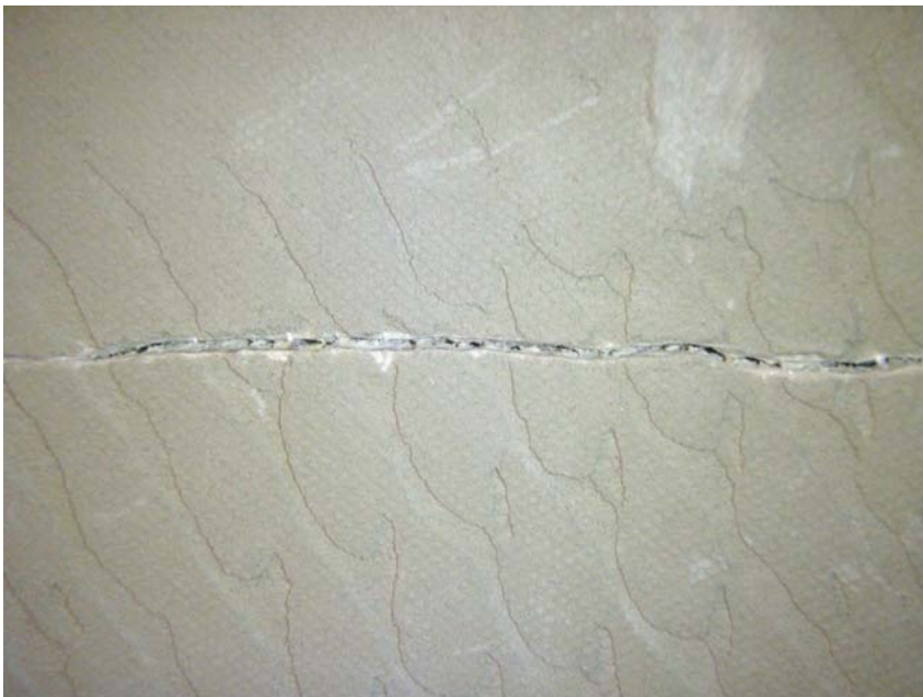
Foto 11. Närbild på en spricka i en våtrumsvägg efter friläggning av kakelplattor, Fotografi från en skadeutredning.
