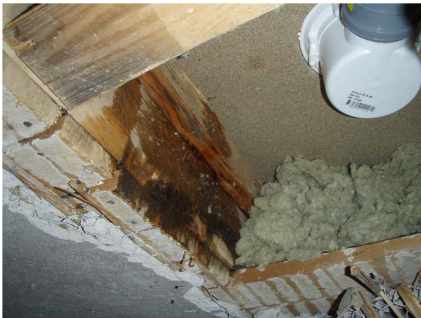
Foto 4. Läckage genom mellanbjälklag på grund av ett flertal fel.
