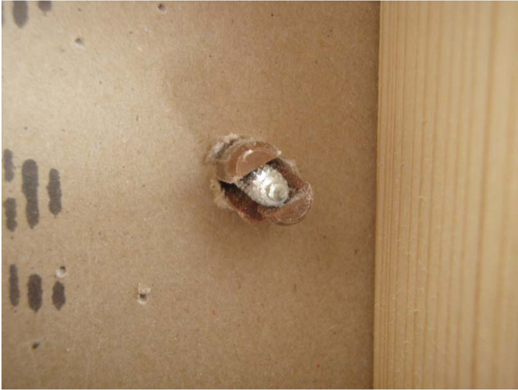
Foto 21. Felaktigt utförd genomföring i våtrumsvägg (foto taget från andra sidan vid en skadeutredning).
