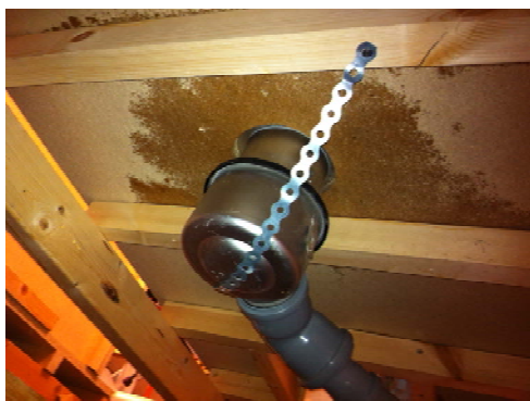
Foto 12. Läckage kring den rostfria golvbrunnen som är synligt från provboxens utsida
