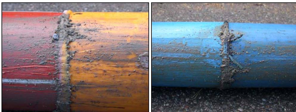
Figur 2-3. Skrapskador på rör och svetsvulster efter släpning på asfalterad gata. Nilsson & Thörnblom (2005).
