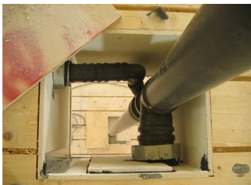
Bild A 28 Schakt genom bjälklag med anslutna VS-rör.
