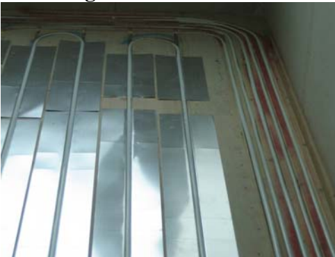
Bild B.9.1 Golvvärmslingor.
