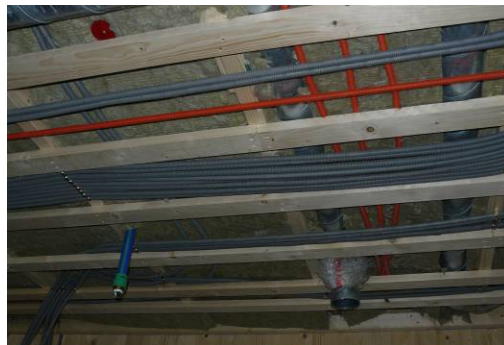
Bild A 25 Undertak med installationer
