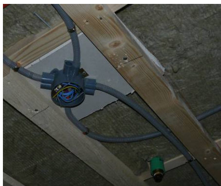
Bild A 27 Eldosa och sprinkler i undertak
