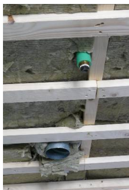
Bild A 26 Ventkanal och sprinklerrör.
