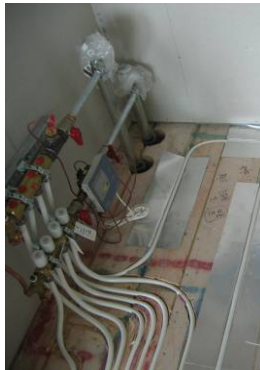
Bild B.9.2 Golvvärme fördelare i lägenhet
