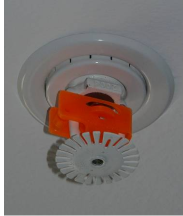
Bild B.2.2 Sprinklerhuvud
