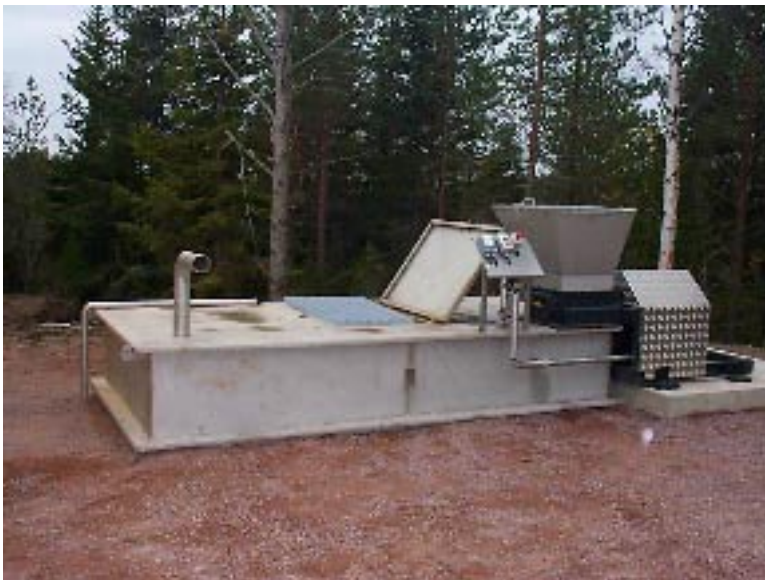
Bild 2. Mottagningsdelen vid anläggningen i Sund, med tippficka (locket uppfällt), kvarn för matavfall samt anslutning till vilken slambilens utlopp kan kopplas.
