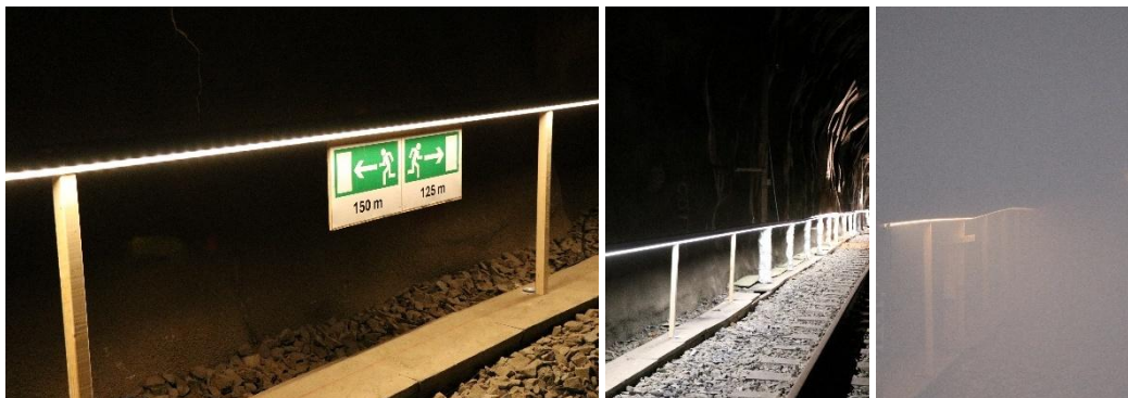
Figur 4. LED-belysning i tunneln, bild till höger under rökfyllnad.
