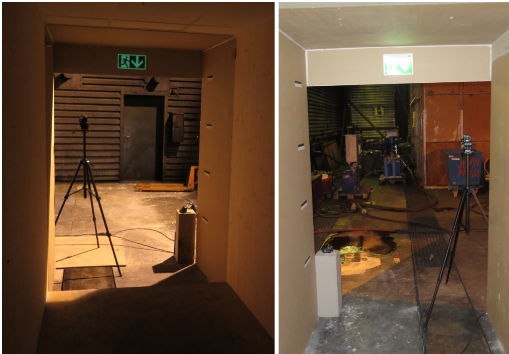
Figur A- 4: Forsøk 1. Etterlysende markeringsskilt montert på venstre korridorside (venstre bilde). Elektrisk markeringsskilt montert på høyre korridorside (høyre bilde).
