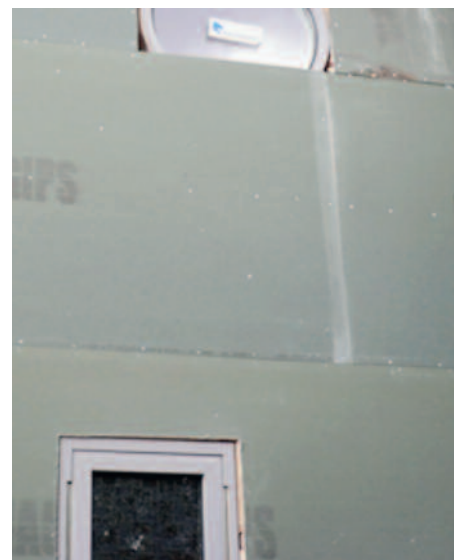
Bild 3: Slarvigt utfört vindskydd med otätade skivskarvar och otät anslutning mot fönster.
