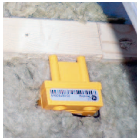
Bild 2: Installerad sensor vid ytterdel av träregel, fastskruvad nära utsida regel.
