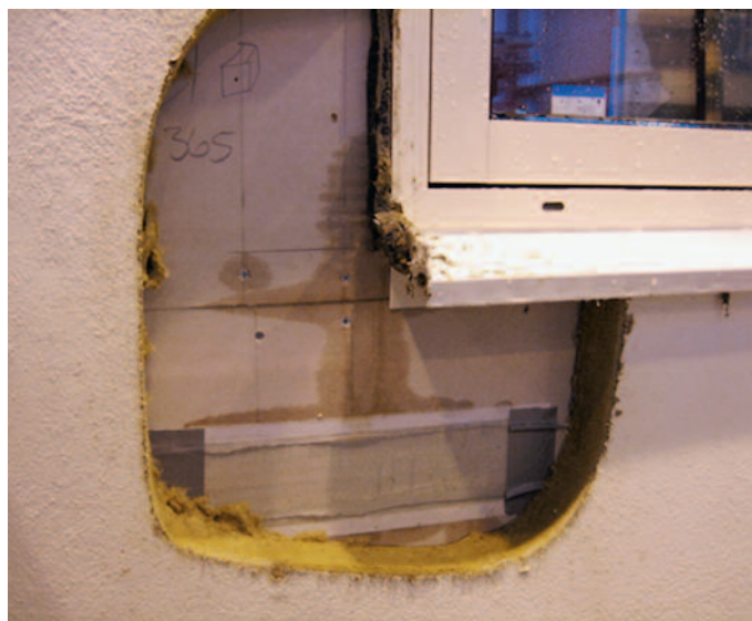
Figur 4: Håltagning i fasad efter slagregnsprovning i anslutning till en fuktindikator strax under ett fönster. Fuktmärkingar syns på stomstabiliserande skiva.
