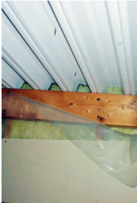
Bild 11: Otät plastfolieanslutning, mellan vägg och tak, mot profilerad takplåt.
