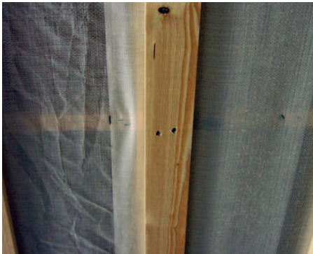
Bild 10: Oklämd och otät plastfolieskarv. Risk för att hål uppstår i plastfolien vid häftklamrar när plastfolien utsätts för belastning från bjälklagsisolering och pulserande tryck när det blåser ute.
