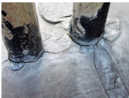
Bild 4: Två rör genomföringar i taktäckningen. Risken är stor för inläckage vid sådana genomföringar långt innan synliga sprickor uppstår.
