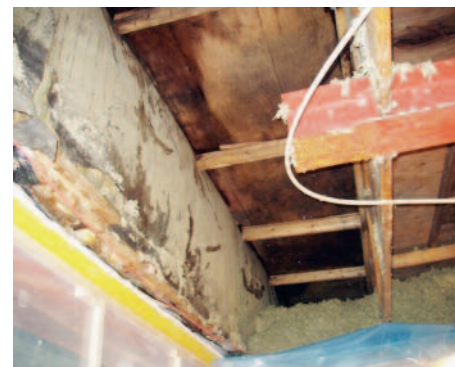
Bild 7: Synliga fuktskador och blött i taket vid friläggning underifrån.
