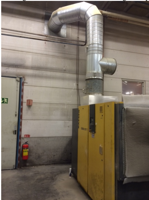
Figur 10: Enkel värmeåtervinning tryckluft, men avsaknad av sval och ren till-luft gör att kompressorn går sämre.
