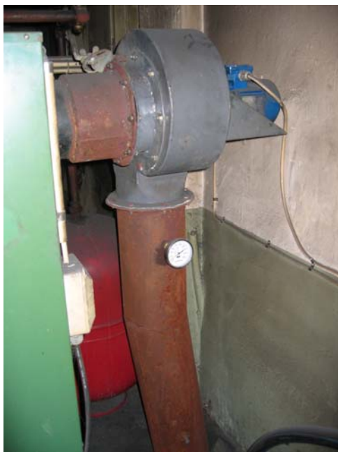
Figur 1. Bilden visar rökgaskanalens utlopp ur pannan via en rökgasfläkt och anslutningen till markkanalen.
