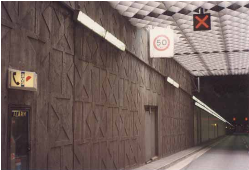
Figur 10. Skjuddörr i Limfjordtunneln, Danmark
