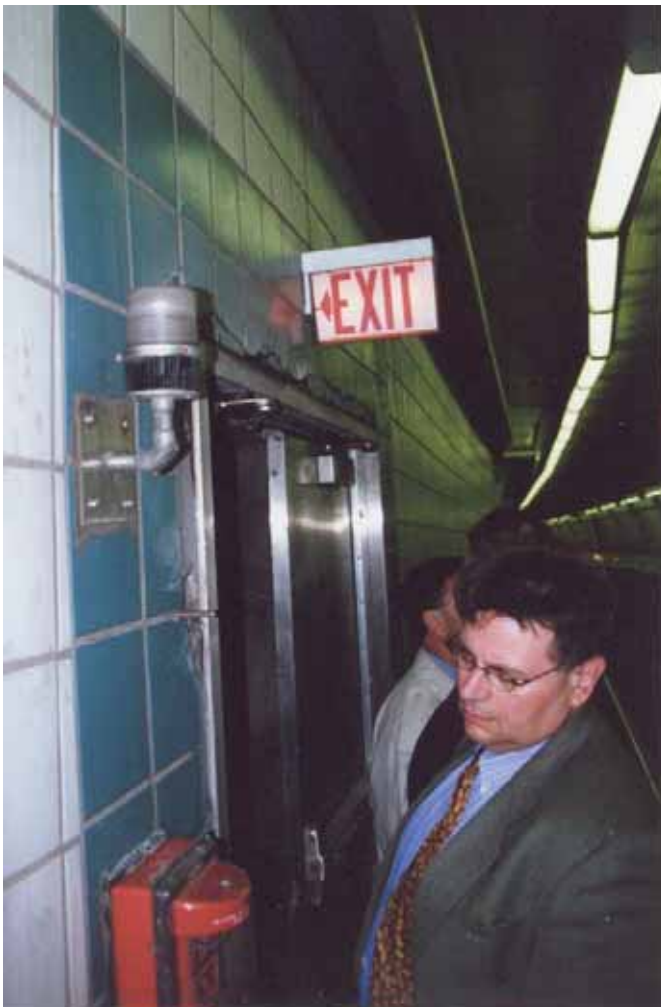
Figur 11. Skjuddörr i tåg tunneln Ted William i Boston
