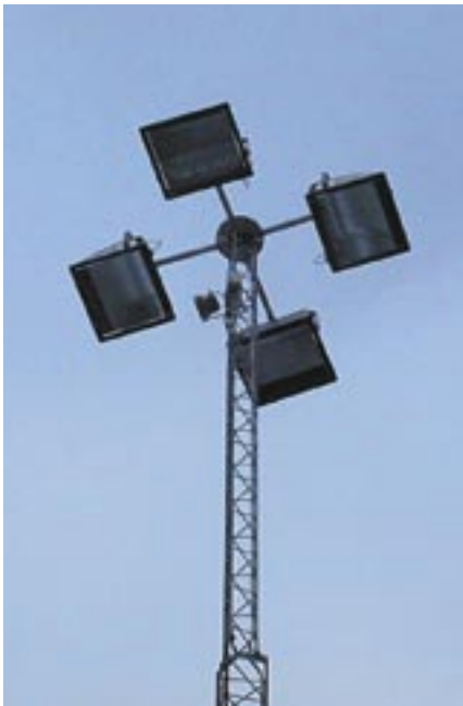
En CDM-lampa monterad på samma mast som fyra högtrycksnatriumarmaturer. Mastens höjd är 24 m.
