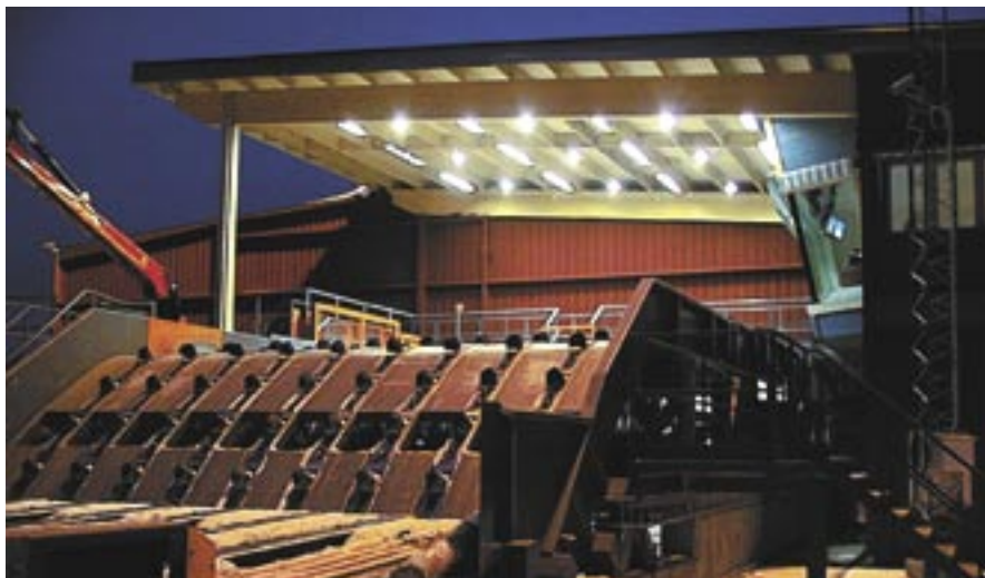
I timmersorteringen ersatte nio CDM-lampor à 70 W (630 W) de befintliga 12 lysrörarmaturer med två rör à 58 W (~ 1400 W). På bilden är båda lamptyperna tända.
