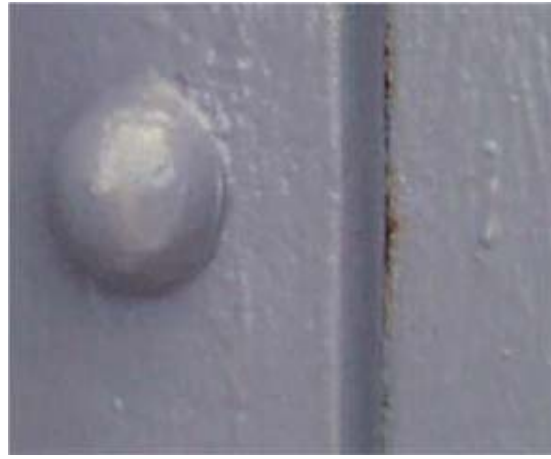
Provyta med färgsystem F6 med Sa 2 där spalt N1 framträder som klart påverkad
