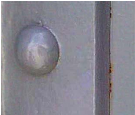
Provyta med färgsystem F7 med Sa2 där spalt N1 framträder som klart påverkad
