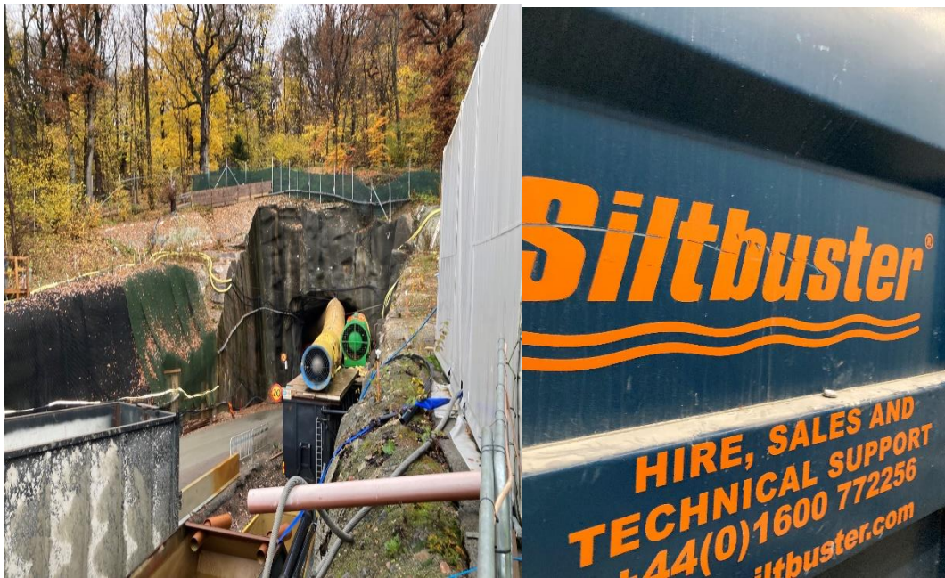
Figur 13: Skårs tunnel 209 samt dess anläggning för vattenbehandling
