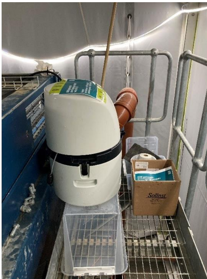
Figur 1: Automatisk provtagare vid utlopp efter befintlig behandling vid ST209, Västlänken i Göteborg
