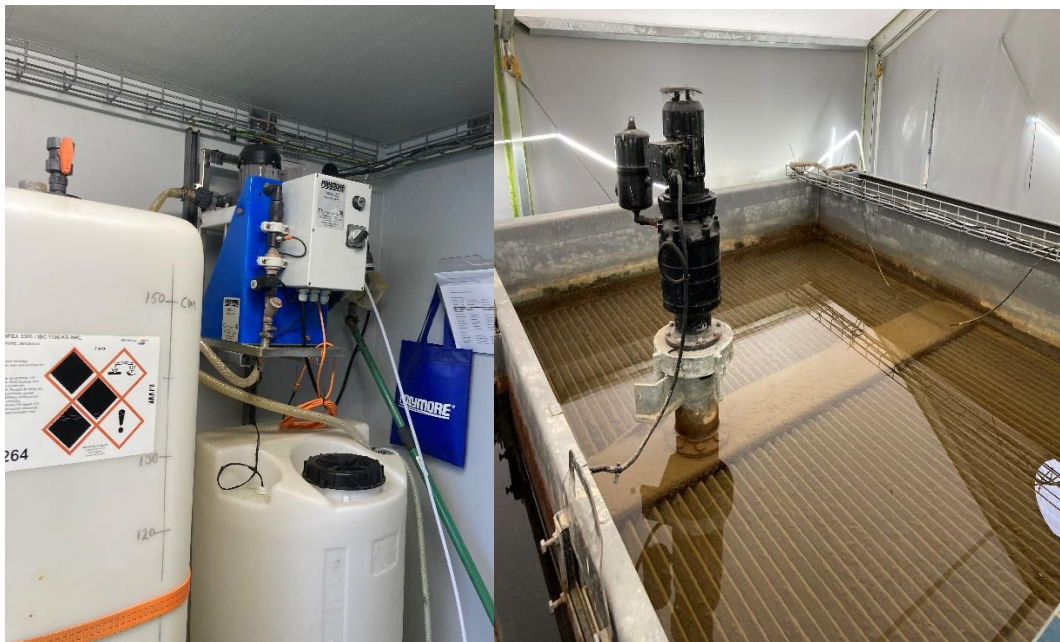
Figur 14: Kemikaliehantering samt lamellsedimentering från befintlig vattenbehandling vid Skårs tunnel ST209
