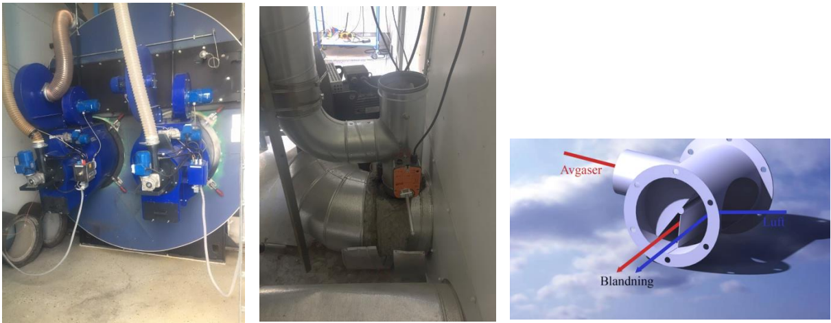
Figur 2a-c. Janfirebrännare med och utan rökgasåterföring samt mixern i närbild.
